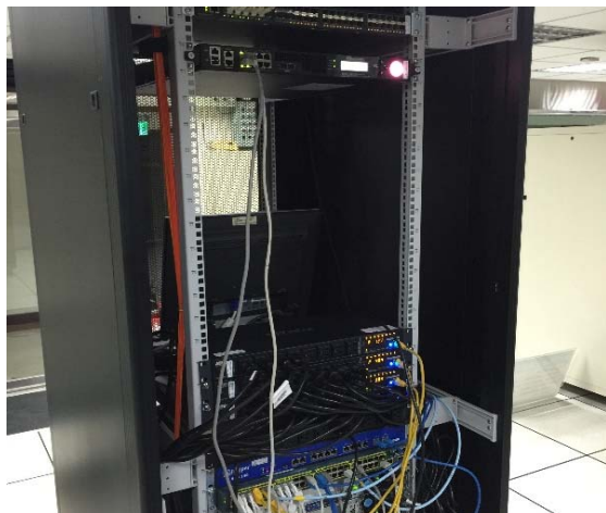
機房機櫃量測
